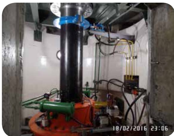
Cerca de tiro en el pozo de la turbina
