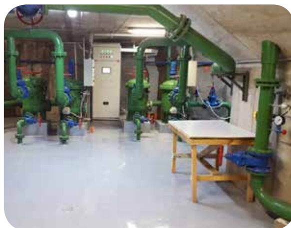
Sistema de agua de refrigeración
