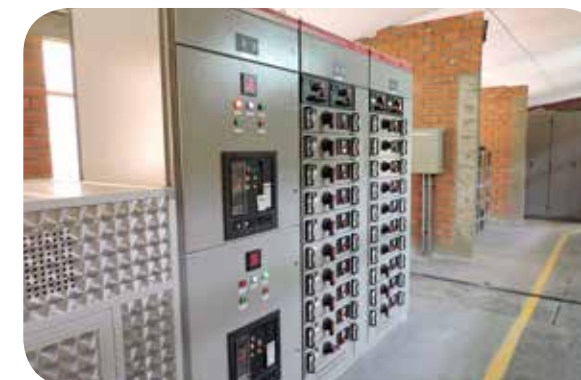
Cubículo de aparamenta
