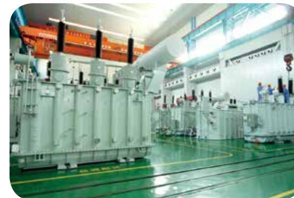
Transformador de potencia principal
