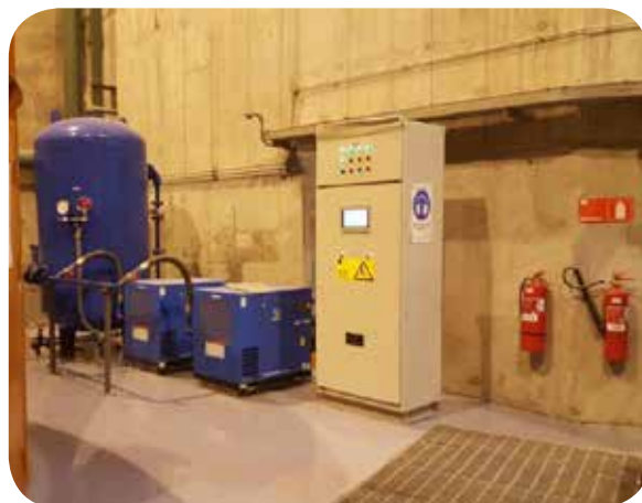
Visión general del sistema de aire comprimido
