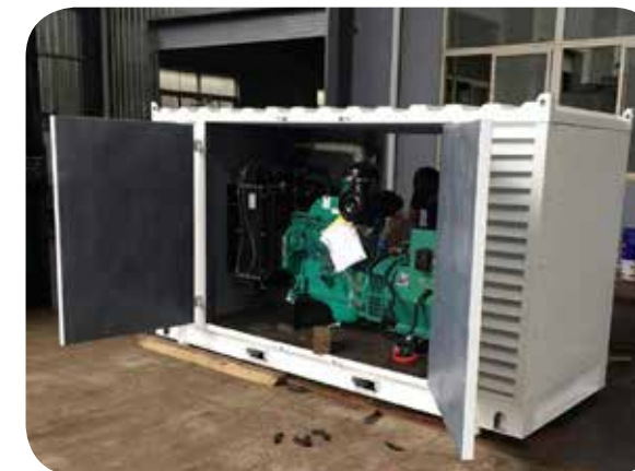
Generador de diesel
