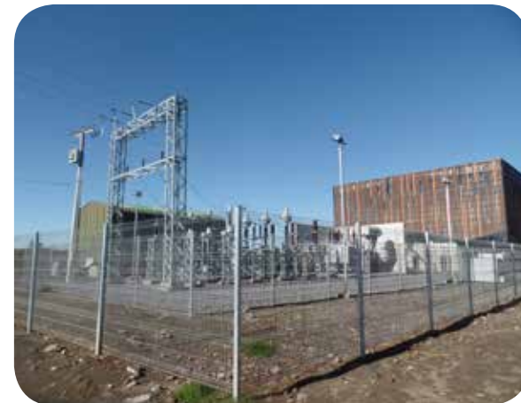
66KV Subestación de montaje
