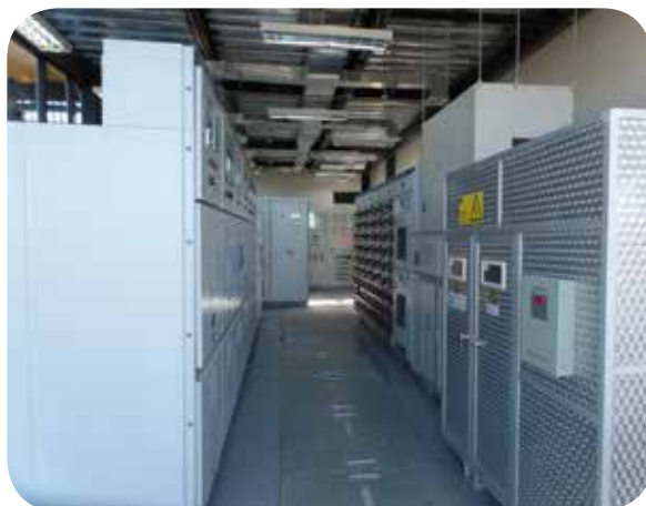
Sala de equipos eléctricos de medio voltaje
