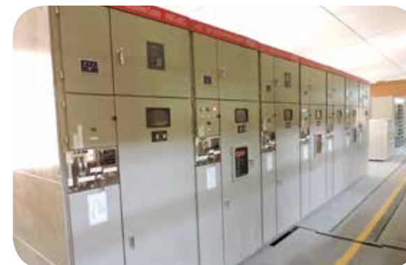
Cubículo de aparamenta
