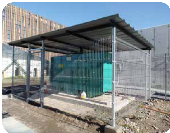
250kVA Cummins diesel generador
