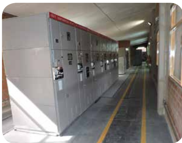
MV Paneles de distribución
